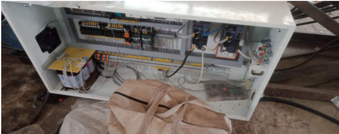
Fig: 3.8 PLC Panel
